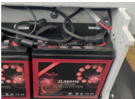
Vano batterie AGM
